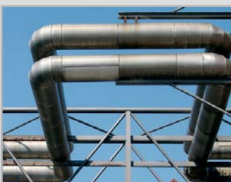
工程管路配件
